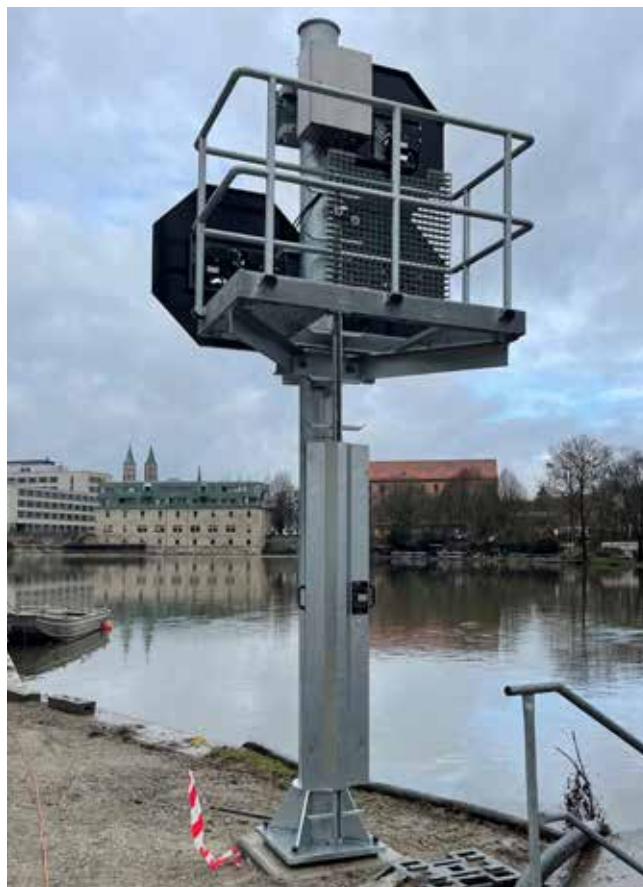
Einfahrtssignalmast Hindrik mit Schleusensignalgruppe Julius und 5 Schleusensignallaternen S 145 LED
