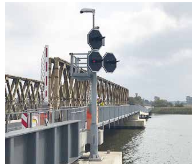
Schleussensignalgruppe mit Schifffahrtssignalmast Hindrik und 6 Schleussensignallaternen S 145 LED
